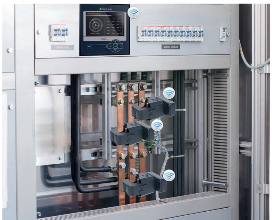
Einsatz der Klappwandler zur dreiphasigen Energieverbrauchsmessung.
